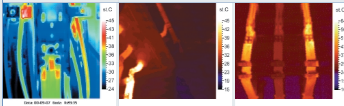
Rozdzielnia przy transformatorze WN Rozdzielnia napięcia 15kV Rozdzielnia napięcia 15kV
